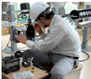
ビジネスフォン等 通信機器設置現場
